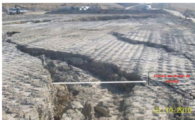
Figure 1: Ouverture de grandes fissures au niveau du remblai de la mine de sel de l'autoroute Fès-Taza (du Pk117+975 au Pk118+575), au cours des travaux (Mouhssine et al. , 2015)
